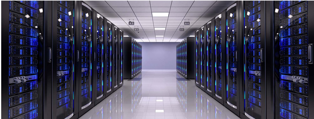
Modernes Data Center (Bildquelle: stock.adobe.com)
