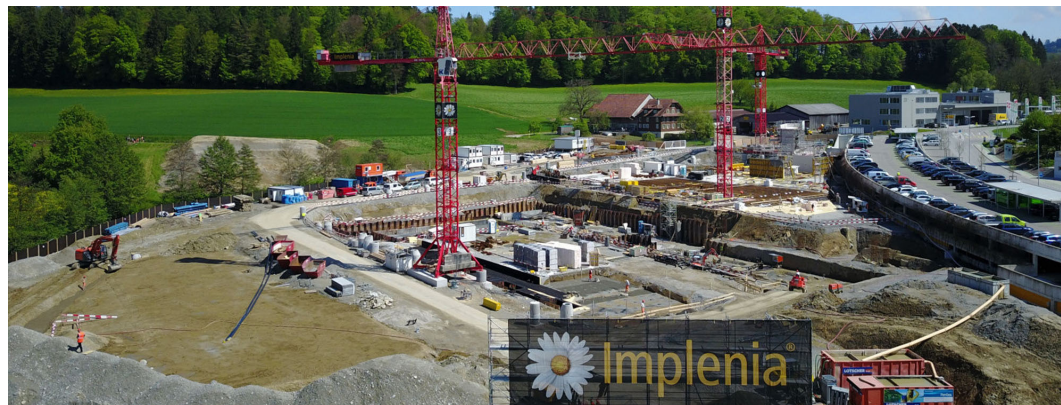
Implenia lors de la construction du Campus Sursee (source de l’image : implenia.com)
