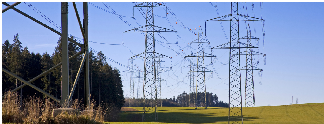
L'infrastructure de distribution d'électricité est nécessaire (Source : stock.adobe.com)
