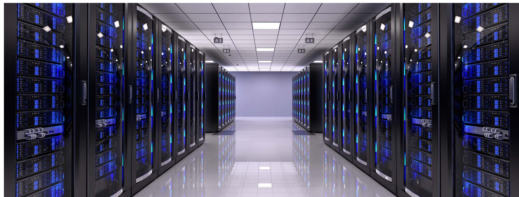
Un data centre moderne (Source de l'image : stock.adobe.com)
